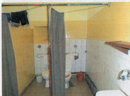
Kącik sanitarny w celi 19-osobowej (AŚ Bytom)
